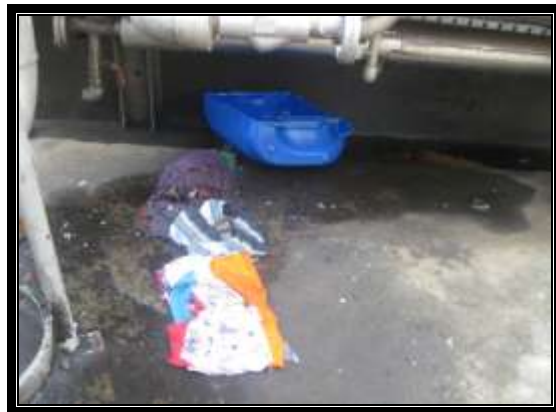
Potensial Insiden pada Februari 2013
